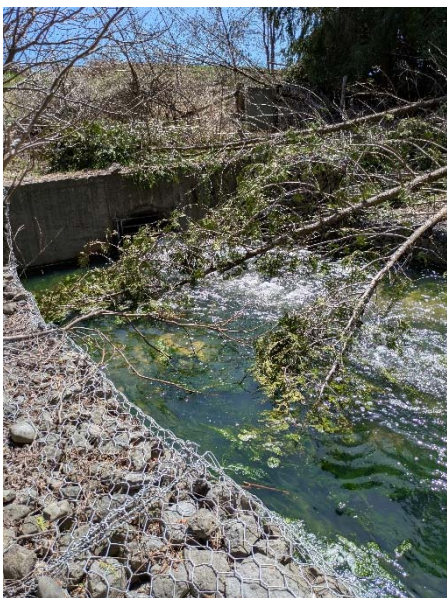
WPCP Effluent: April 2025
